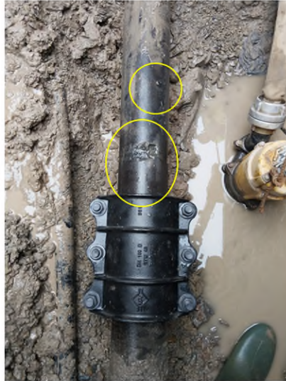
- Provisorisch repariert und weitere Schäden
